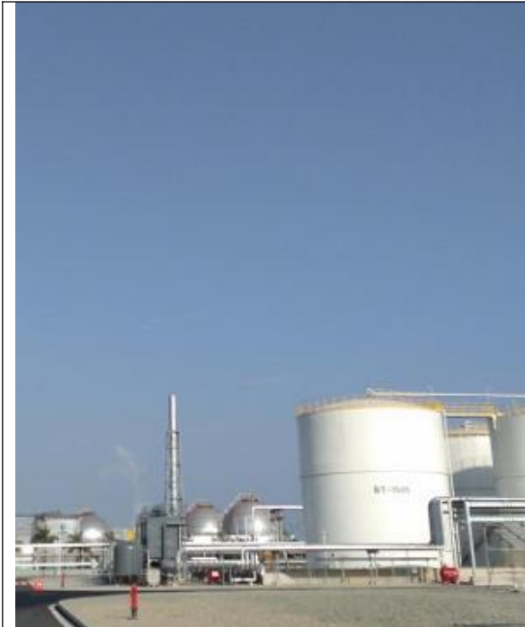
1#两级活性炭吸附+蒸汽脱附+冷凝回收废气处 理设施（储罐呼吸、装车、室外调和
