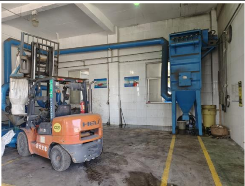
投料粉尘治理设备
