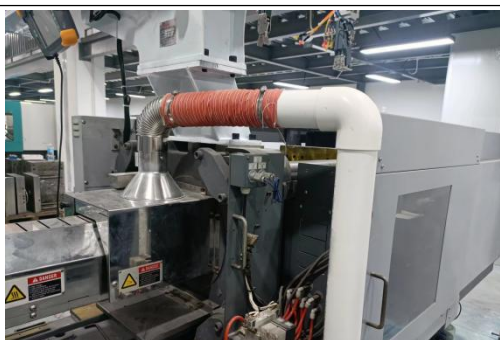
注塑机集气设施
