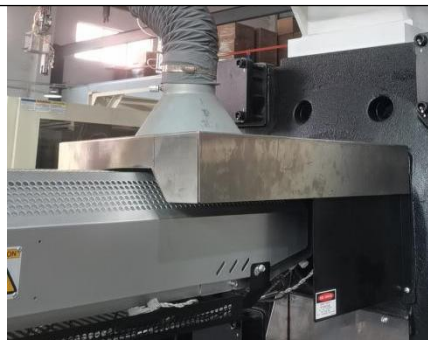
注塑机集气设施
